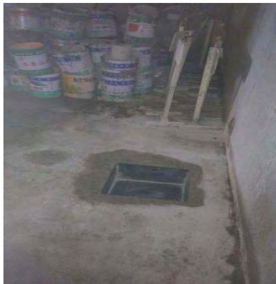
图 8-7 危废暂存款内集液坑
