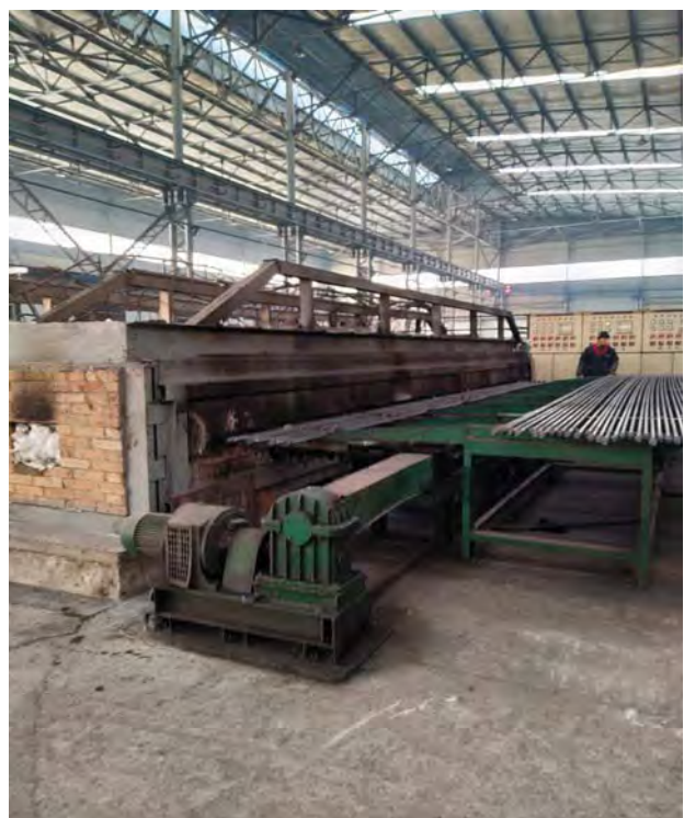
图 2-9 抽油杆工艺的淬火炉
