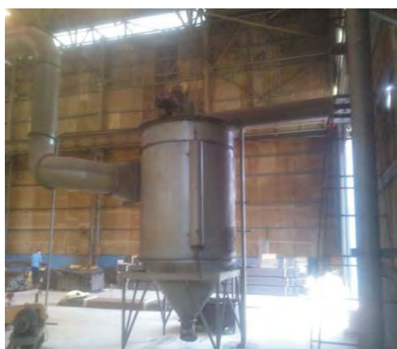
图 3-2 打磨工序摺式滤筒除尘器
