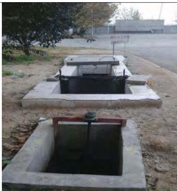
图 8-4 厂区总排口切断闸门
